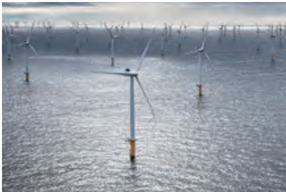
洋上風力発電設備
