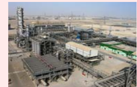
メタノールプラント
