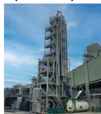
CO 2 回収パイロットプラント (関西電力姫路第二発電所)
