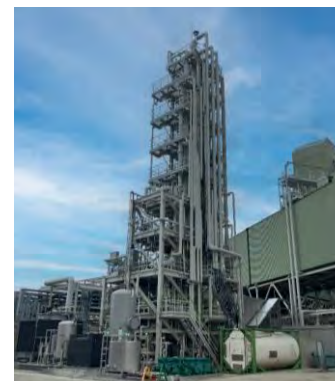
CO 2 回収パイロットプラント (関西電力姫路第二発電所)
