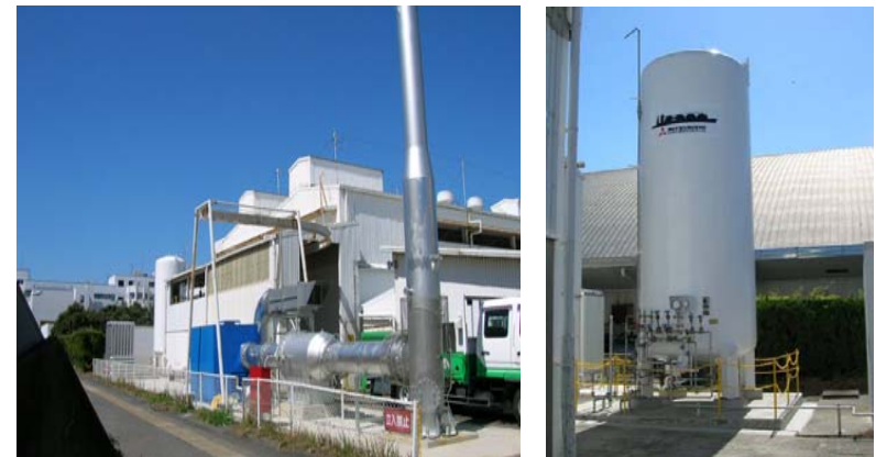
試験設備外観(長崎研究所)
