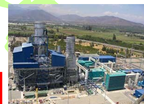
チリ SanIsidro II M701F 2008年運開
