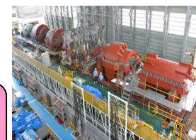
【エチレンプラント用コンプレッサ】
