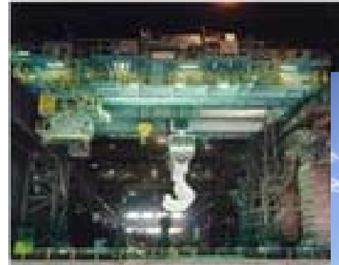
製鉄用レードルクレーン
