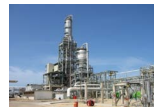
ポリエチレンプラント
