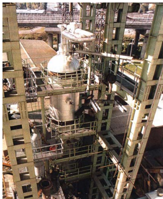
蒸気発生器気水分離器実圧試験
