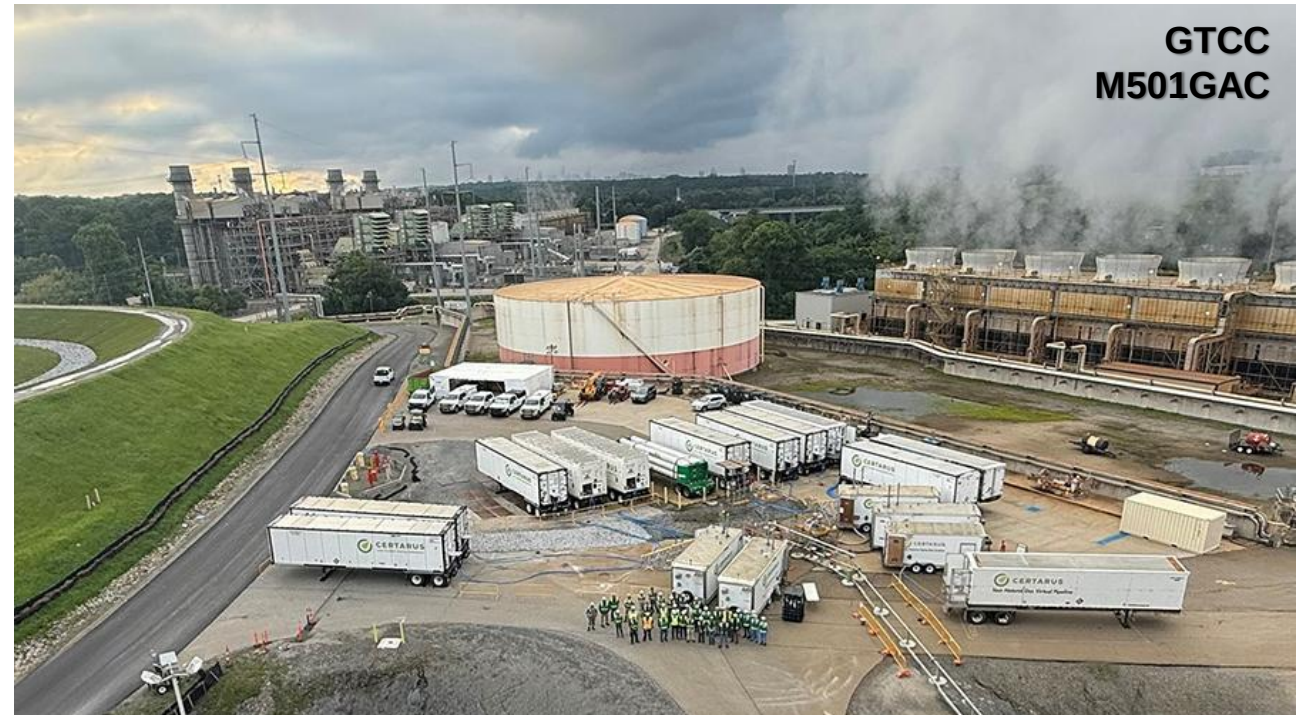
写真 水素混焼運転の全景 および プロジェクト関係者 (2012運開・既設GTCC発電所)
