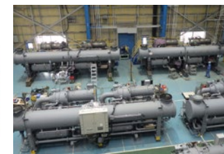
ターボ冷凍機
