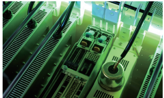
液体で機器を冷却する様子
