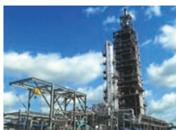
CO 2 回収プラント
