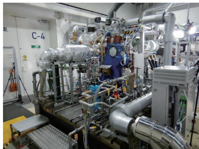
図8 産総研 福島再生可能エネルギー研究所に設置された水素エンジン
