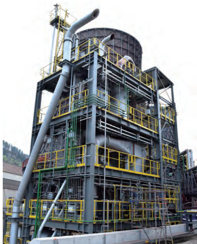
図32 水素還元製鉄(HYFORパイロットプラント)
