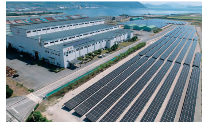
図36 三原製作所和沖工場内に設置された太陽光発電設備
