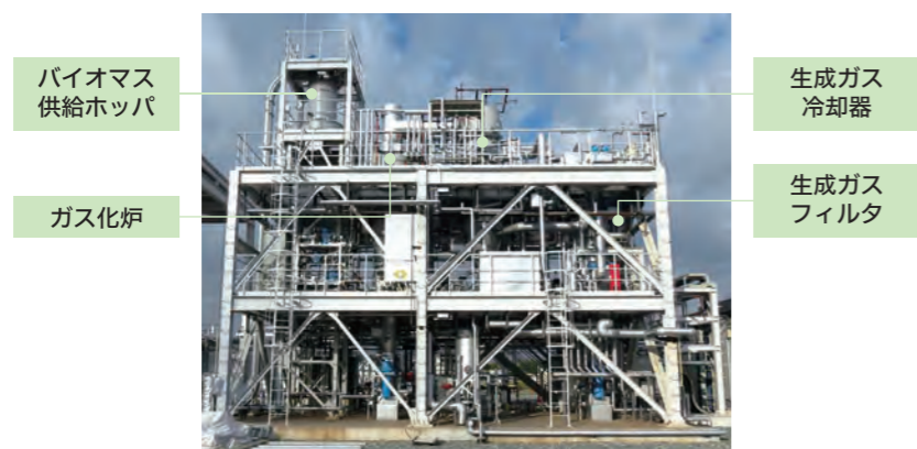
バイオマスガス化設備
