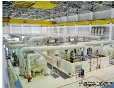
原子力タービン発電設備
