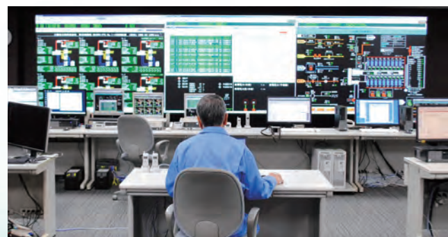
遠隔監視センター
