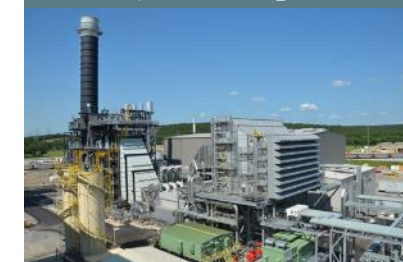
GTCC・発電プラント
