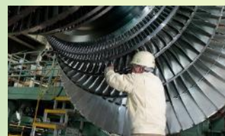
蒸気タービン
