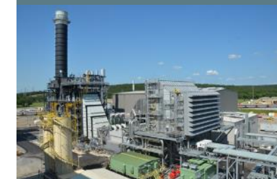
GTCC・発電プラント
