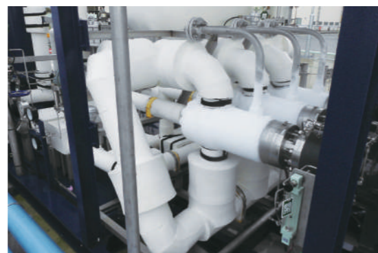
HP LNG pump
