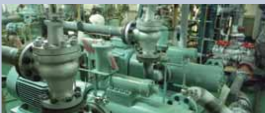
实施改造的燃料泵
