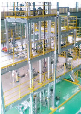
CO 2 回収パイロット装置
