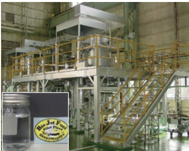
バイオジェット燃料製造設備
