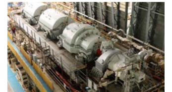
三菱重工コンプレッサ(株) 工業プラント用大型コンプレッサ
