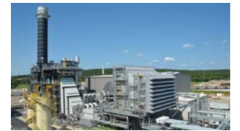
三菱重工(株) ガスタービンコンバインドサイクル発電プラント(GTCC) / GRDA社 グランドリバーエネルギーセンター
