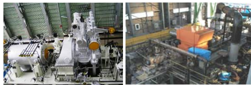
Compressor for LNG
